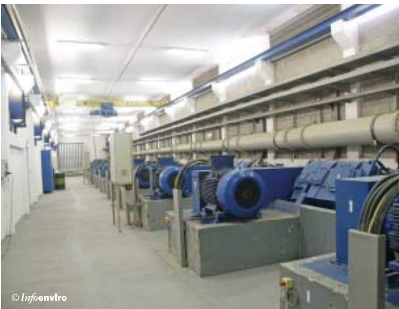
Sala de motores de los tornillos de elevación de agua bruta
