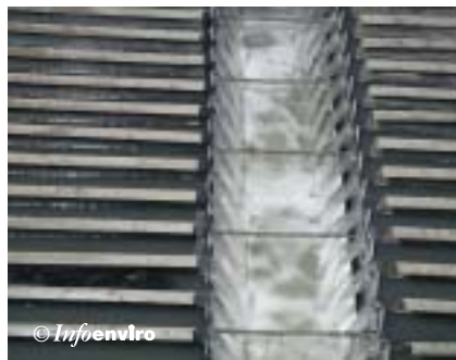
Canales de recogida del agua decantada en el sistema lamelar
