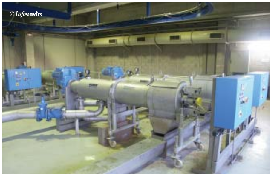
Equipos de tamizado de los fangos primarios
