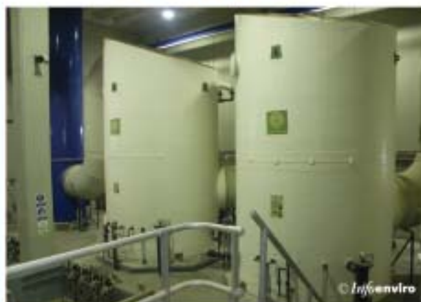
Torres de lavado de la desodorización en tratamiento preliminar
