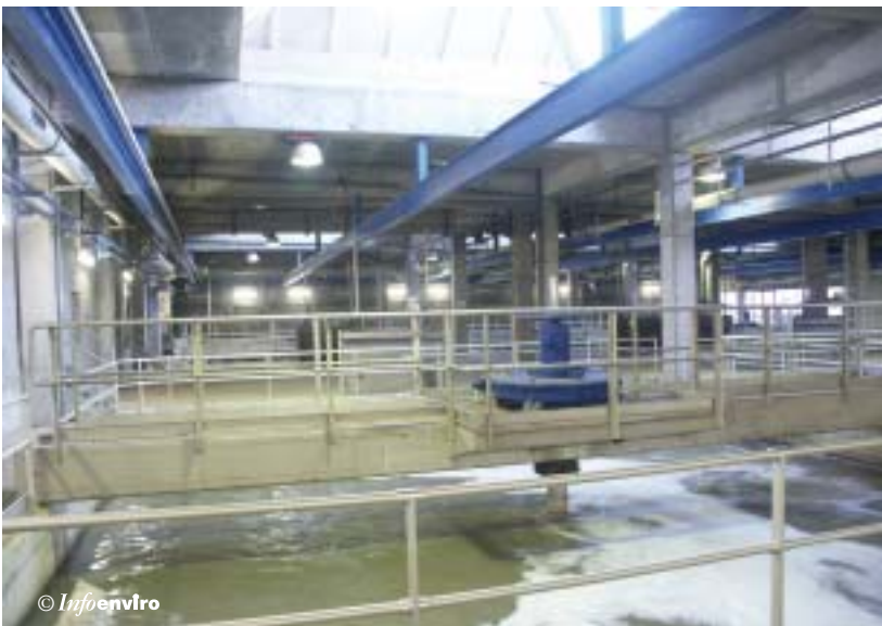
Sala de desarenado
