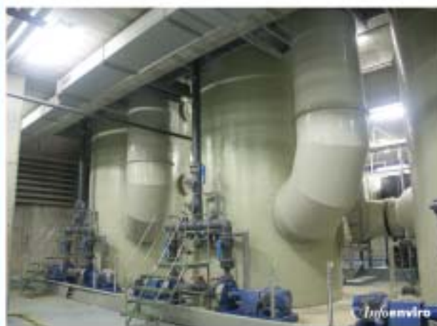
Torres de lavado de la desodorización en tratamiento primario
