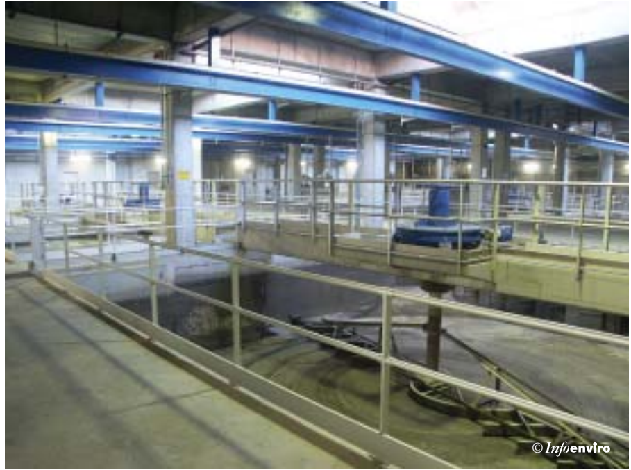
Desarenador tipo "detrítus" y rasquetas de arrastre
