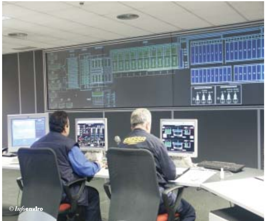
Sala de control
